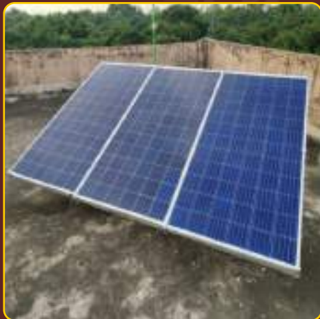
Rooftop PV module
